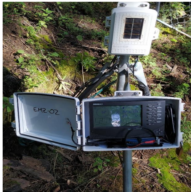
Figura 2 Estación meteorológica automática
